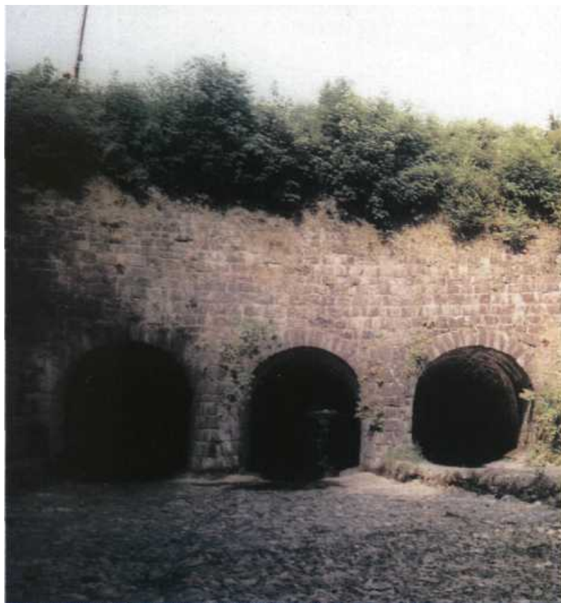
Tunele pod kanałem pozwalają na przejście pod dnem
